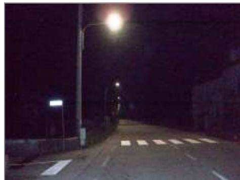
Un tratto della strada provinciale illuminato con le nuove lampade
